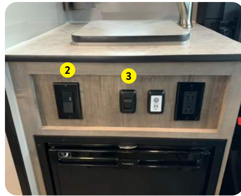
2. Interrupteur de chauffe-eau
