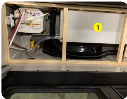
1. Réservoir eau potable
