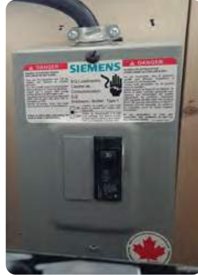
Le disjoncteur du réseau électrique.
